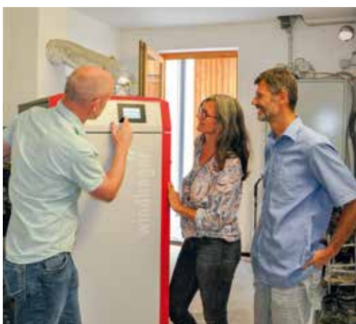
Die Hackguthheizung von Windhager sorgt für behagliche Wärme im Haus. Mittels Förderschnecke werden die Hackschnitzel vom angrenzenden Lagerraum in den Ofen transportiert.
