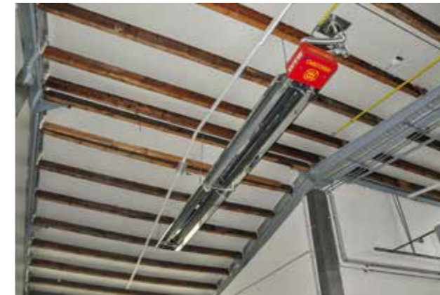
Mit diesen Infrarotstrahlern haben es die Produktionsmitarbeiter in den Hallen jetzt warm. Bei den verwendeten Dunkelstrahlern fällt die Brandgefahr nahezu weg, außerdem wird die Strahlungswärme oft als angenehmer empfunden im Gegensatz zu Hellstrahlern.
