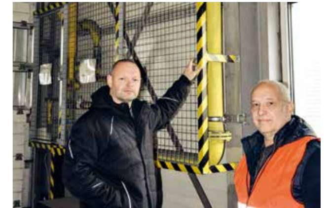
Martin Dirnberger und Kurt Moser zeigen die neu installierten Gasleitungen in einer der Werkshallen.
