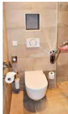
Ein Zimmer wurde barrierefrei gestaltet. Das WC der Marke Laufen ist mit einer elektronischen Spülauslösung und einem Stützklappgriff ausgestattet.
