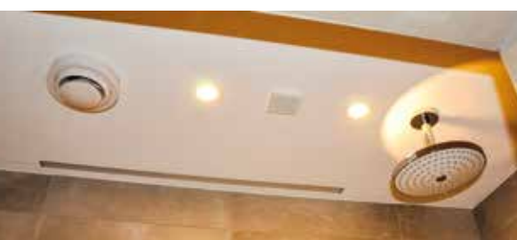
Bei dieser Brausetechnologie vermischt Hansgrohe Wasser und Luft und sie verspüren ein wohlzig perlendes Gefühl auf der ganzen Haut. Ein weiterer Vorteil – der Wasserverbrauch wird erheblich gesenkt. Die Abluftabsaugung wird automatisch mit dem Licht aktiviert und sorgt für angenehmes Raumklima.
