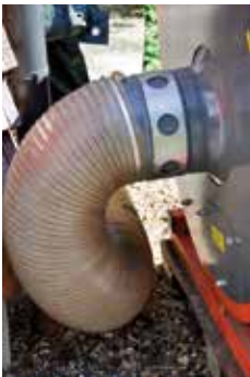
Über einen Befüllschlauch wird das Hackgut angesaugt und in den Silo geblasen.
