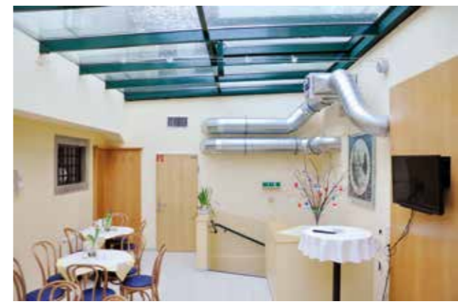
Die verbrauchte Luft wird mittels Rohrsystem in die Anlage am Dachboden gesaugt, dort umgewälzt und frische, warme Luft kommt retour.
