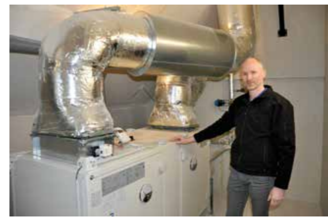
Am Dachboden des Hauses steht die Anlage für das neue Lüftungssystem. Bis zu 1.000 m³ Luft/Std. werden hier umgewälzt.
