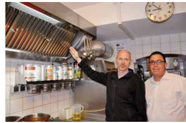
Die verbrauchte Luft wird über der Herdstelle mittels einer 5-Stufen Regelung abgesaugt.
