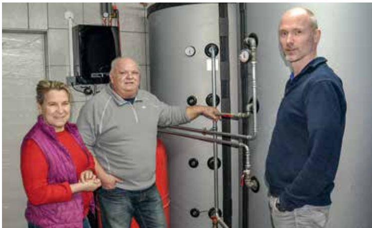
Zwei Pufferspeicher mit einem Fassungsvermögen von insgesamt 3.000 l gleichen die Differenzen zwischen der erzeugten und der verbrauchten Wärmeleistung aus. Das ETA-Schichtlademodul sorgt dafür, dass die Energie aus der Solaranlage optimal genutzt wird.
