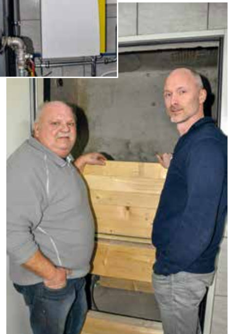
Der Pelletslagererraum ist durch eine Tür, direkt vom Heizraum aus, zugänglich. Mit vier Saugsonden werden die Pellets zum Brennofen transportiert.
