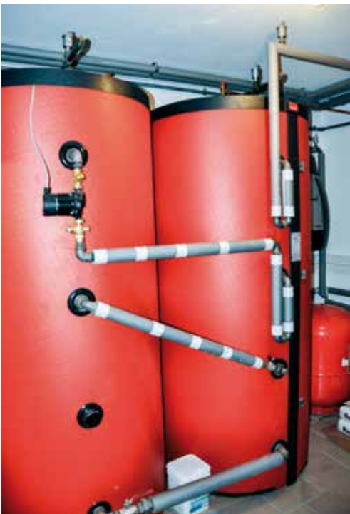
Die Heizung funktioniert mit zwei 1000 l Pufferspeicher und holt das Optimum aus der Anlage.
