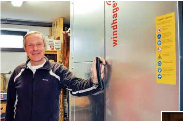
Eine trockene und staubfreie Aufbewahrung der Pellets bietet dieser Lagerraum aus Stahl. Die Pelletszuführung zum Heizkessel erfolgt mittels einem 3-Sonden-Saugsystem.
