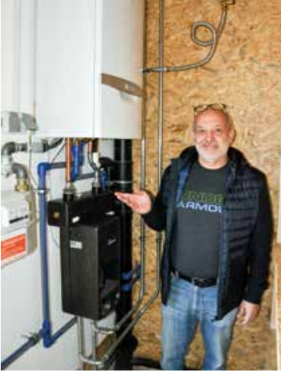
Das Gebäude wird mittels einem Gas-Brennwert Heizgerät der Marke Vaillant mit Wärme und Warmwasser versorgt. Techniker Kurt Moser von Haustechnik Fichtinger in Mauthausen, stand immer beratend zur Seite.
