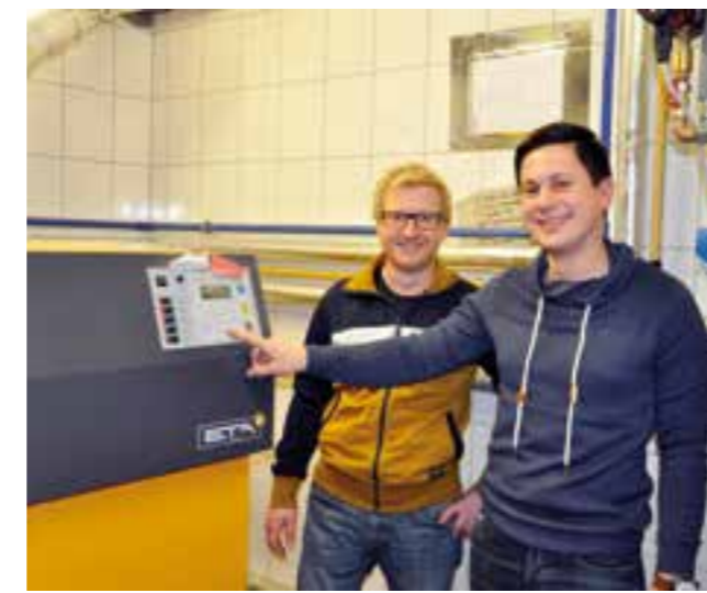
Die Heizung wurde bereits vor drei Jahren erneuert und versorgt das gesamte Haus mit Wärme. Martin Heiligenbrunner war damals wie jetzt bei den Installationsarbeiten der beratende Fachmann.
